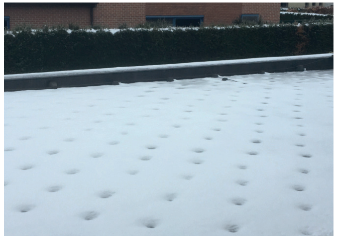
Foto 2: smeltpunten in de sneeuw door warmtelekken op een plat dak, door gebruik van metalen (niet thermische) isolatiebevestiging.
