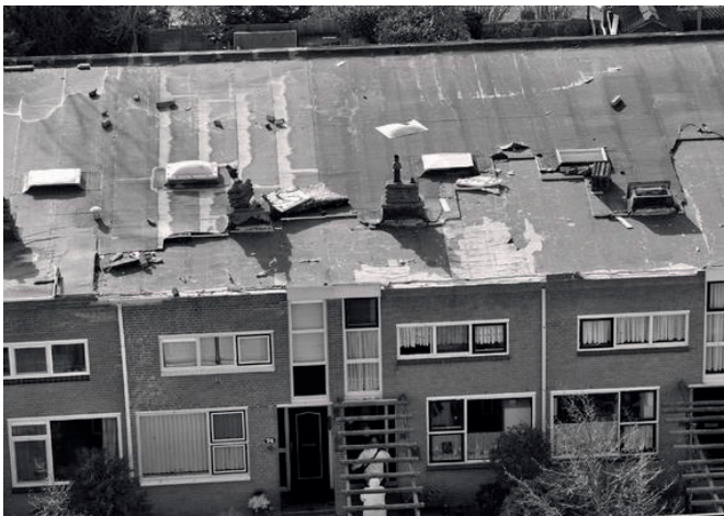
Foto 1: plat dak zonder mechanische bevestiging, na stormschade. Photo 1: toiture plate sans fixation mécanique, dégâts tempête.
